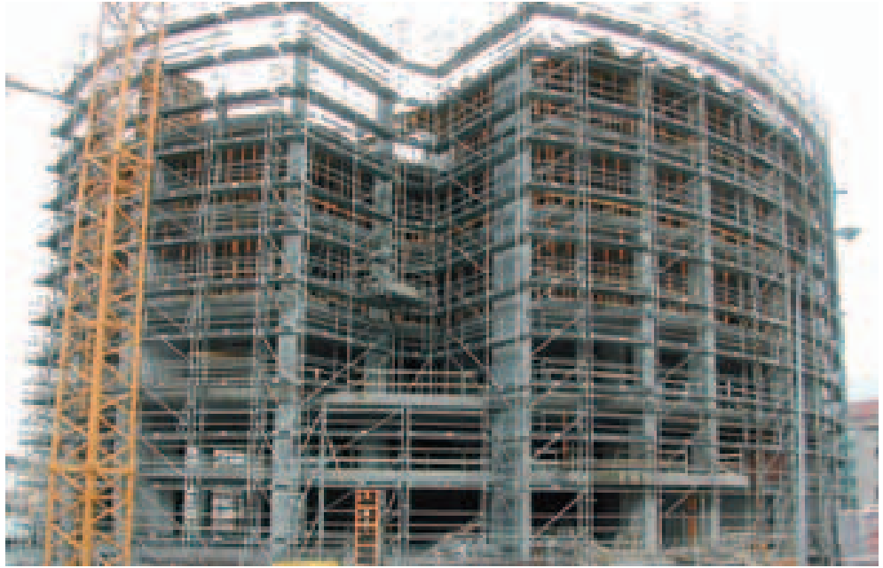
Montaje para el cerramiento de fachada en la Torre de Cristal, La Coruña, España
